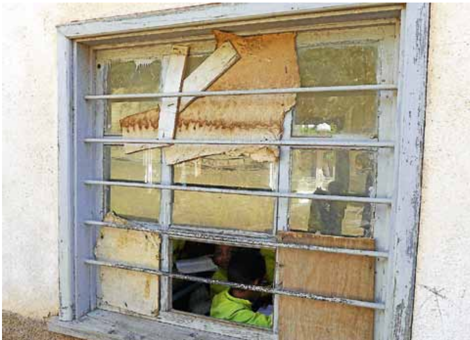
Die alten Fenster müssen dringend erneuert werden Foto: vol
